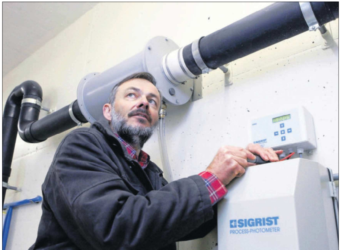
Anton Bachmann misst im Pumpwerk bei Berchtwil die Wasserhärte. Das Werk ist wegen der Reussdammsanierung derzeit nicht am Netz.
